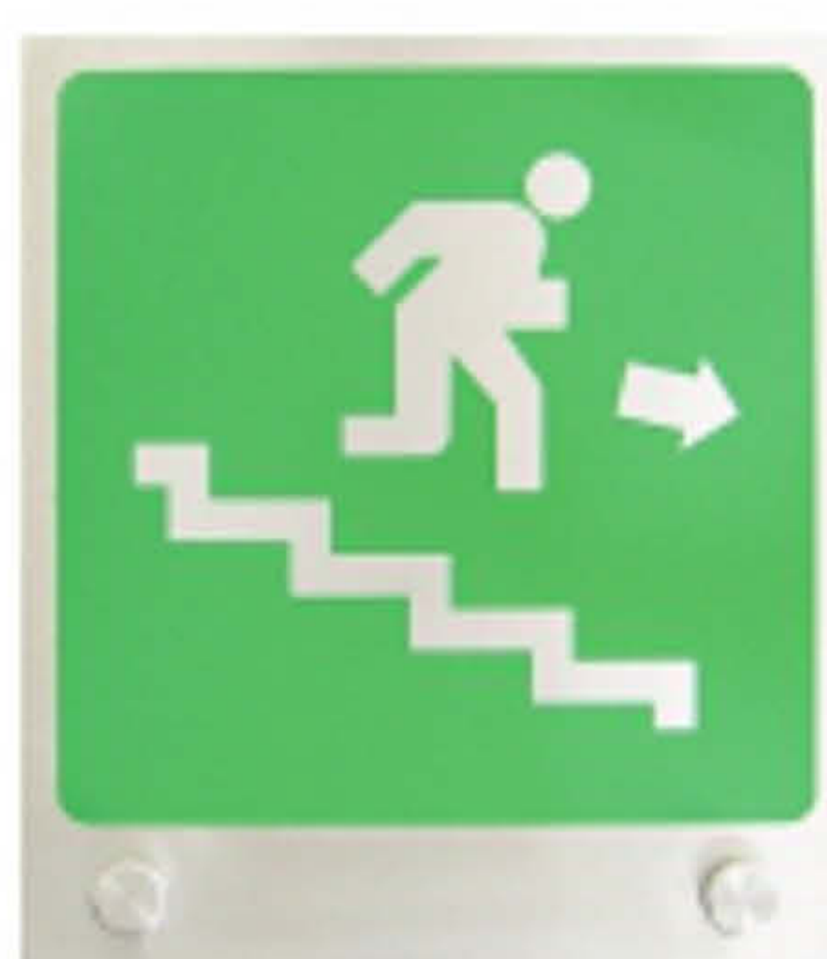
Fluchtweg Treppe hinunter Via di fuga scala giù Escape road down the stairs
